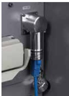
LANケーブル接続口
