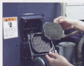
エアフィルターの汚れを確認
